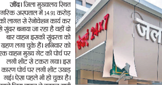
जींद। जिला मुख्यालय स्थित नागरिक अस्पताल में 14.91 करोड़ की लागत से रेनोवेशन कार्य कर इसे सुंदर बनाया जा रहा है वहीं दो बार वाहन इसकी सुंदरता को गड़बड़ लगा चुके हैं। शनिवार को एक वाहन मुख्य गेट की पोर्च पर लगी शीट से टकरा गया। इस कारण पोर्च पर लगी शीट उखड़ गई। ऐसा पहले भी हो चुका है। पहले जिस वाहन ने टक्कर मारी थी, उसका पता नहीं चला। इस बार पुलिस ने वाहन चालक की शिकायत पुलिस को दे दी है। कुछ लोगों का आरोप है कि पोर्च की हाइट बहुत कम होने के कारण ऊंचाई वाले वाहन इसमें टकरा जाते हैं। शीट लगाने से पहले कोई भी वाहन पोर्च से कभी नहीं टकराता था। नागरिक अस्पताल का लगभग 14.91 करोड़ रुपये से जीर्णोद्धार करवाया जा रहा है। जब से अस्पताल के जीर्णोद्धार का काम शुरू हुआ है तभी से इस पर खालिया मिशनल उठाए जा रहे हैं। अब इसकी विजिलेंस जांच भी हो चुकी है। एडवोकेट सुनील कुमार ने विजिलेंस को दी अपनी शिकायत में कहा कि जब बिल्डिंग पूरी तरह से कंडम है तो फिर इस पर जो पैसे लगाए जा रहे हैं वह व्यर्थ हैं। अब पोर्च पर जो शीट लगाई गई है वह बहुत कम हाइट पर लगा दी गई है। ऐसे में ज्यादा ऊंचाई वाला वाहन इसमें टकरा जाता है और शीट उखड़ जाती है।
